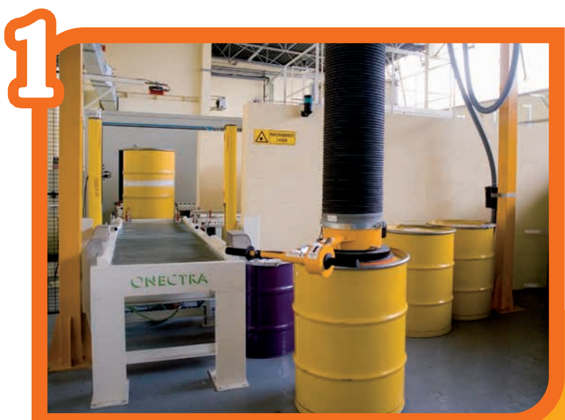
Installation Sandra B à Fontenay-aux-Roses.
