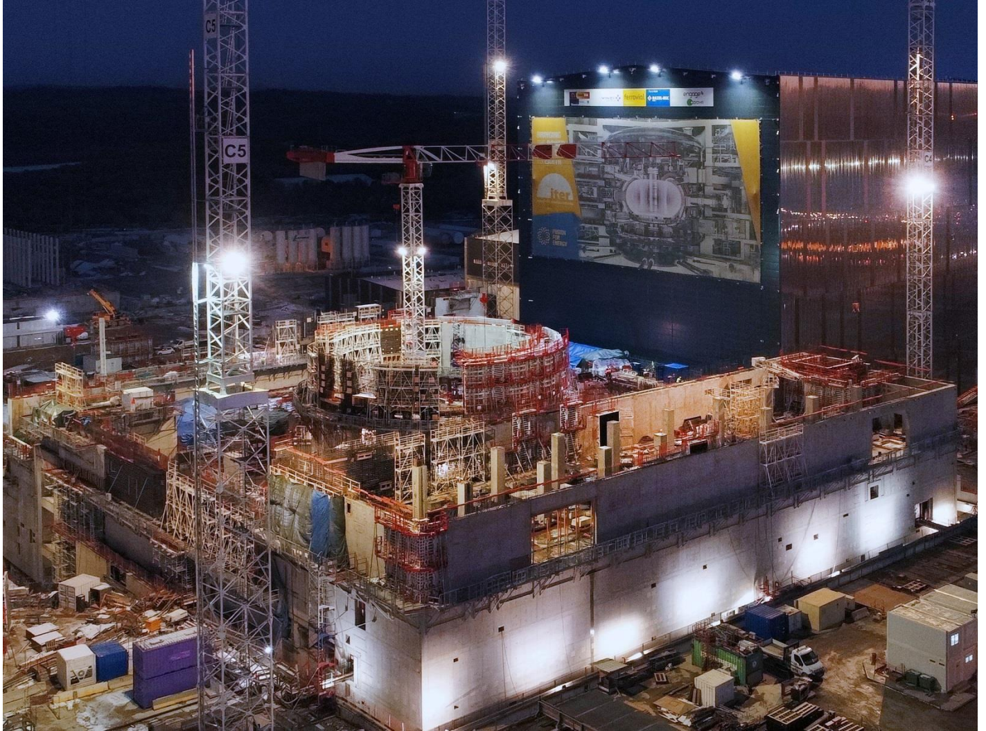
La construction des bâtiments ITER a démarré en 2010. Au cœur de la plateforme, le Complexe tokamak prend forme en décembre 2017. © ITER Organization
